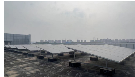
북경P/T 옥상 태양광 설치 현황
